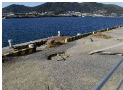
物揚場エプロン部陥没 (黒崎地区)
