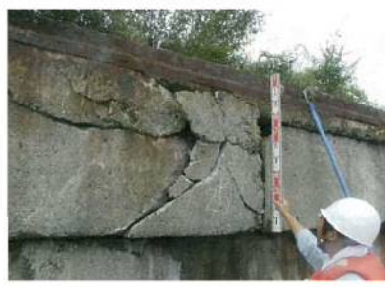
上部工割れ(43年経過)
