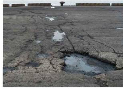
エプロンひび割れ、剥離(34年経過)
