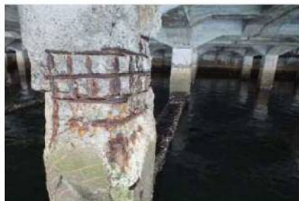
栈橋脚柱部鉄筋露出(48年経過)
