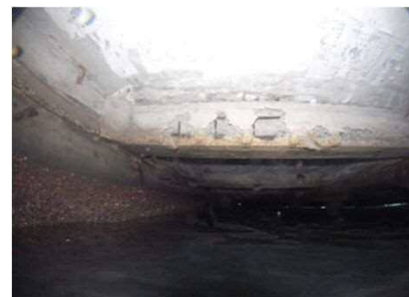
栈橋上部工欠損 (北湊地区)
