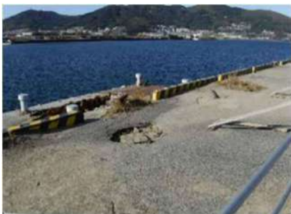
物揚場エプロン部陥没 （黒崎地区）
