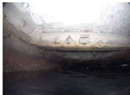
栈橋上部工欠損 （北湊地区）
