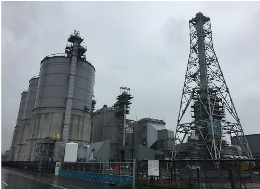
響灘エネルギーパーク合同会社 発電所
