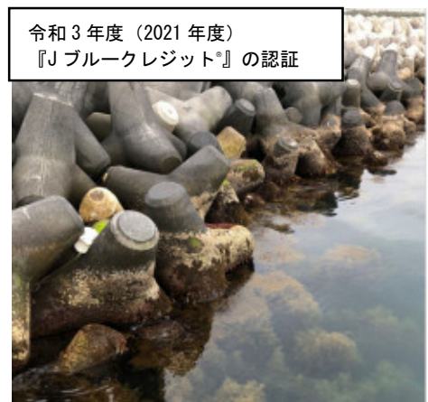
J-POWER 若松総合事業所の周辺護岸における ブロック設置による藻場造成
